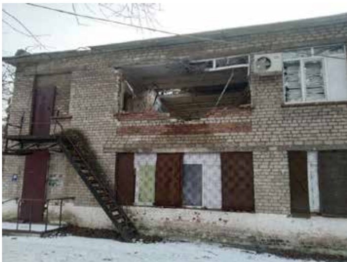
Напівзруйнований двоповерховий цегляний будинок. На другому поверсі вибиті вікна та нема передньої стіни в центральній частині. Вікна на першому поверсі заставлені дошками.
