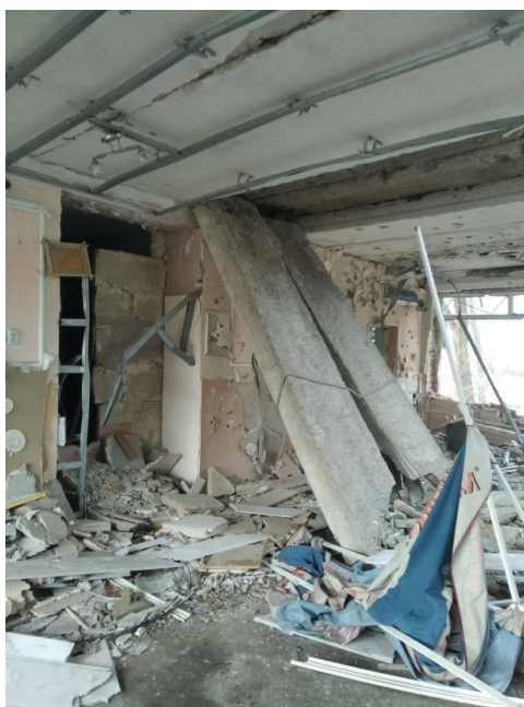
На фото приміщення Клубу Повір у себе, зруйноване російською ракетою у 2022 році.
